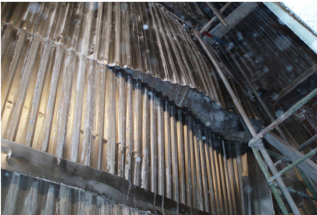
Bild: En dålig kanalvägg gav vika.
